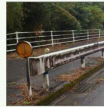
汚れたガードレール
